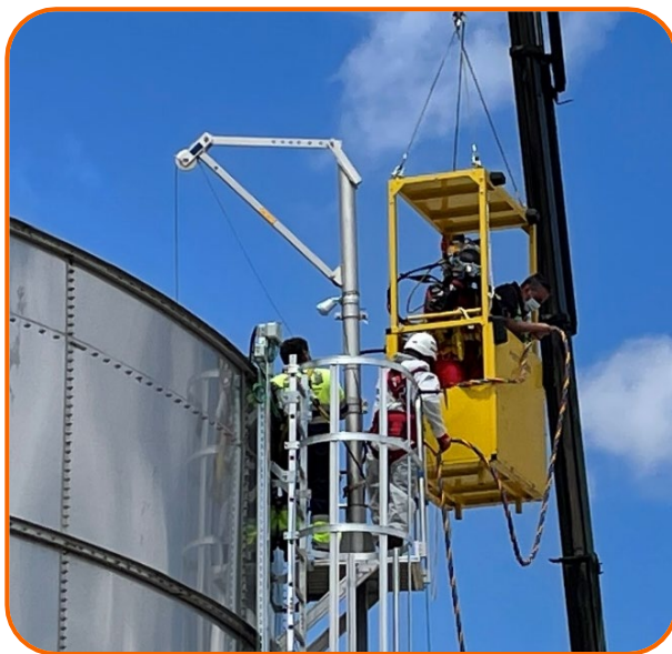
Mantenimiento de EDAR, EBAR, EBAP, ETAP, EDARI, EBARI.
